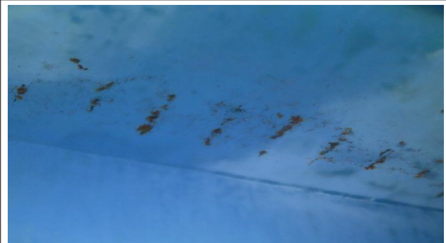
배수지 1지 상부슬래브 철근노출
