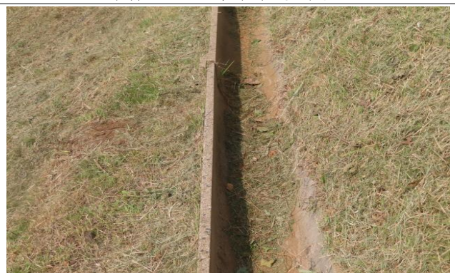
기타 부대시설 배수로 토사퇴적
