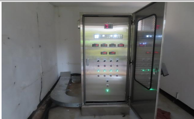
전기설비 원격제어판넬 상태양호
