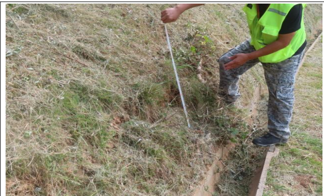
외관조사 손상 크기측정
