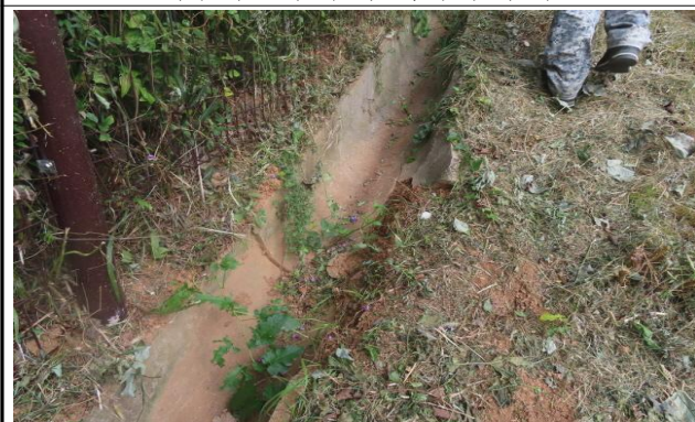
기타 부대시설 배수로파손
