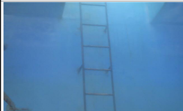
배수지 2지 수직 사다리 부식
