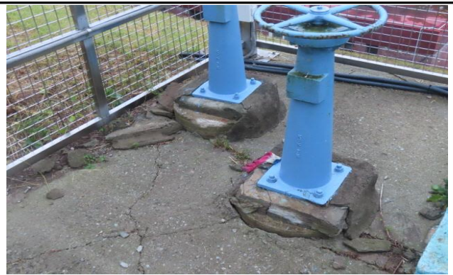
배수지 외부입구 파손(모르타르)
