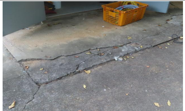
기타 부대시설 장내 포장파손
