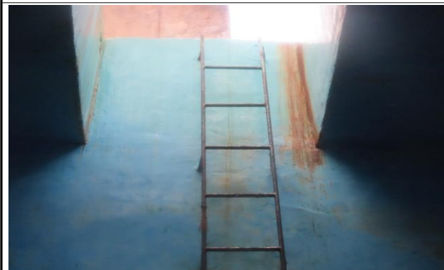
배수지 1지 수직 사다리 부식
