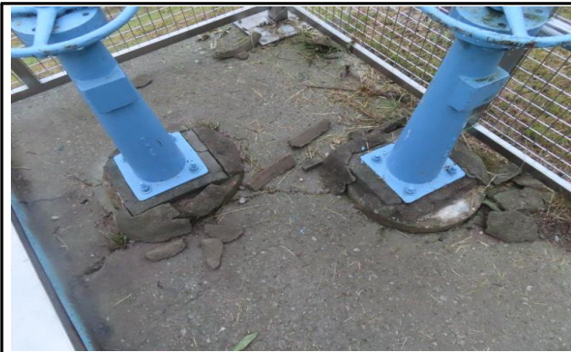
배수지 외부입구 파손(모르타르)
