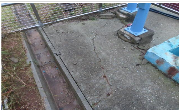
배수지 외부입구 균열(1.0mm이상)
