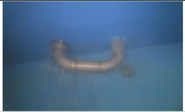
배수지 2지 유입 배관 차수불량
