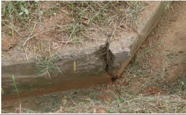
기타 부대시설 배수로파손
