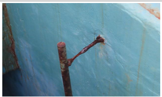
배수지 1지 수직 사다리 부식
