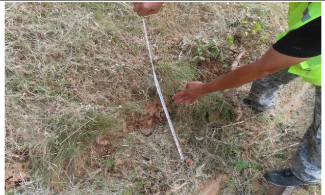
기타 부대시설 사면침식
