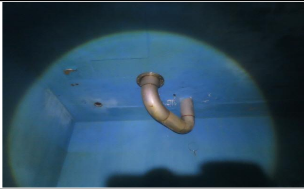
배수지 1지 유입 배관 차수불량
